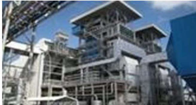
Gambar 1. 3 Unit utilitas batubara PT. Petrokimia Gresik
