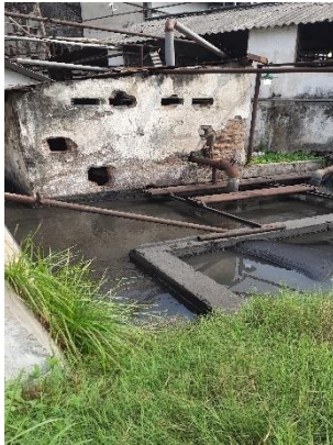
Instalasi Pengolahan Air Limbah (IPAL)
