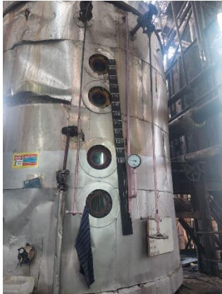
Vacuum Pan pada stasiun masakan
