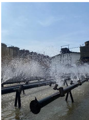
Spray pond yang digunakan sebagai cooling water
