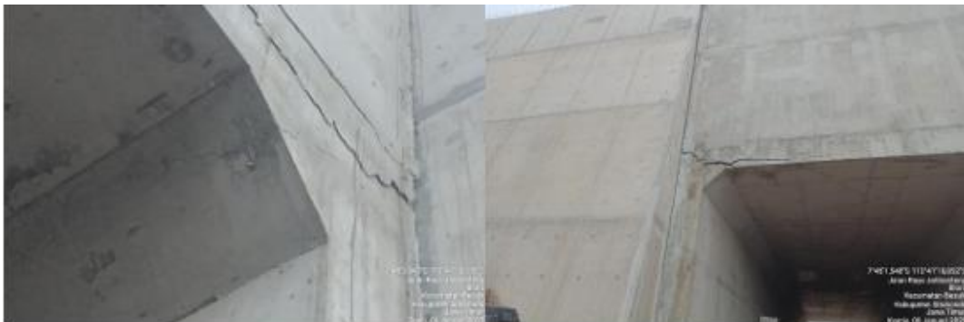
Gambar 9.2 Kondisi Keretakan Pada Box Pedestrian Basian Sumber: PT Parama Karya Mandiri KSO (2025)
