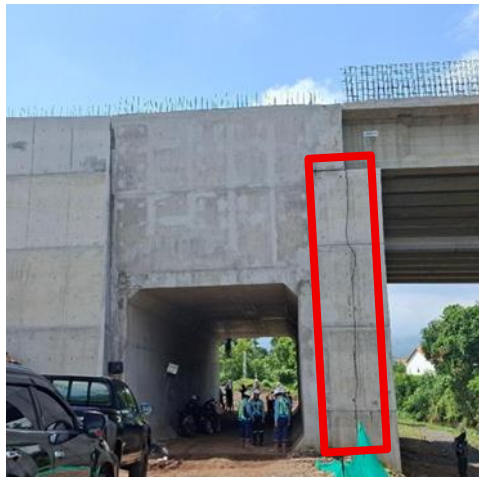
Gambar 9.3 Keretakan Box Pedestrian Basian Pada Sisi Utara Sumber: PT Parama Karya Mandiri KSO (2025)
