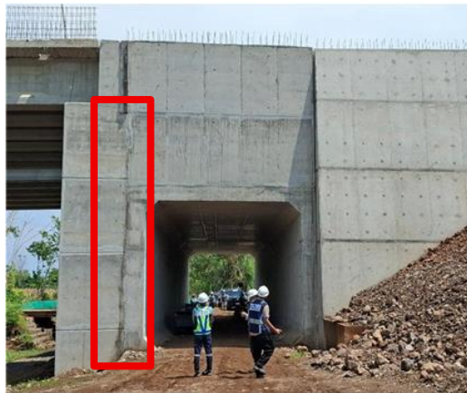
Gambar 9.4 Keretakan Box Pedestrian Basian Pada Sisi Selatan Sumber: PT Parama Karya Mandiri KSO (2025)
