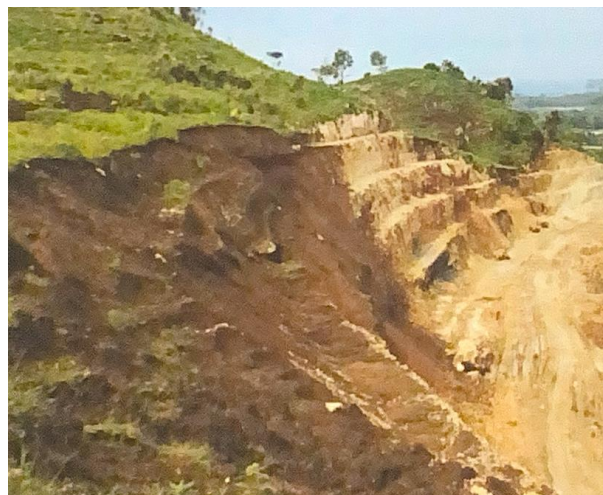
Gambar 1.1 Kondisi Longsor pada STA 1+075 – 1+100 Sumber: Sofi Suhaimah (2025)
