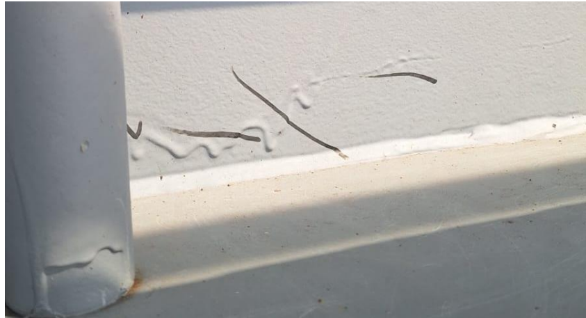
Gambar 1. 3 Defect sagging hasil painting pada blok kapal
