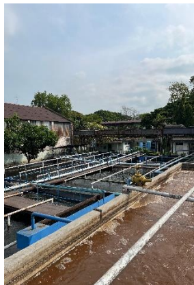
Gambar 11. Instalasi Pengolahan Air Limbah (IPAL)
