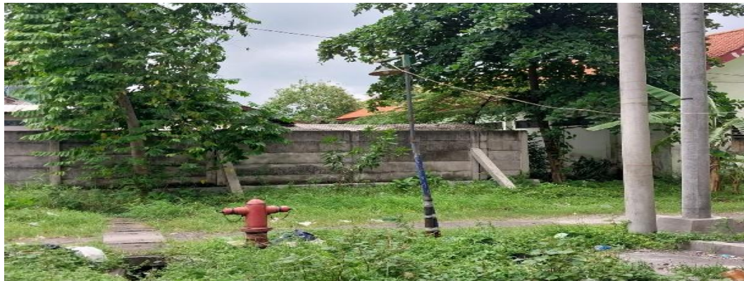
Gambar 1.3 Kondisi Tembok Pengaman dan Hidran Rusunawa Wonocolo Sumber : Dokumentasi Penulis, Desember 2025
