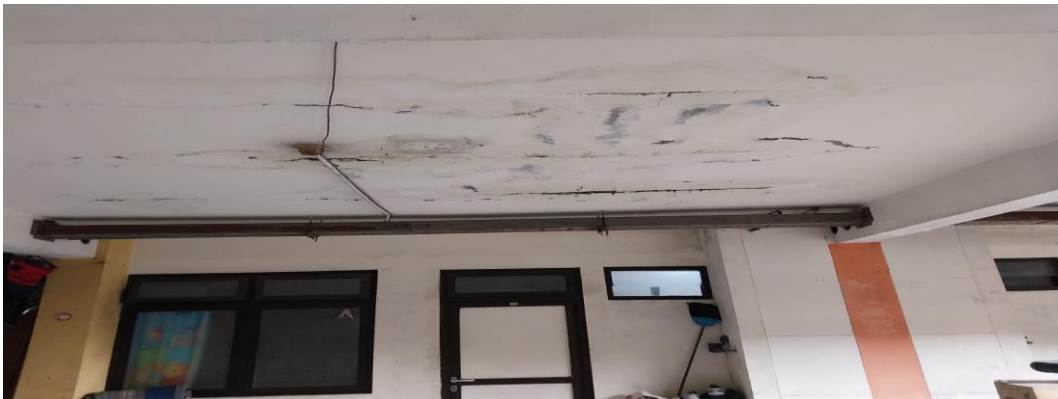
Gambar 1.4 Kebocoran Dek Plafon Lantai 5 Blok A yang Membahayakan Akses Tangga
