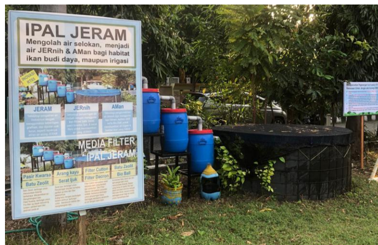
Gambar 1.7 Instalansi Pengolahan Air Limbah Jernih dan Aman (IPAL JERAM)
