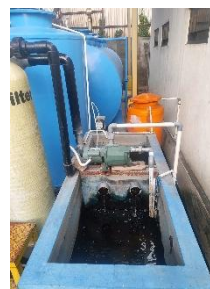
Gambar 4.21 Fasilitas IPAL Industri
