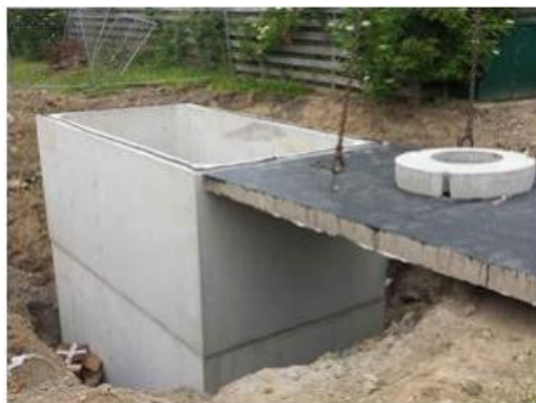
Gambar 2. 14. Reservoar Beton Cor
