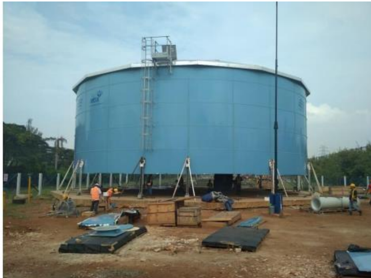
Gambar 2. 13. Reservoar Tangki Baja
