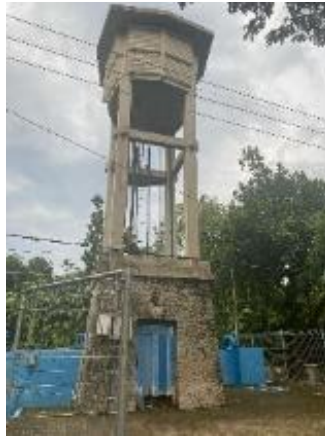
Gambar 2. 10 Bak Pelepas Tekan dan Menara Air Sajen Perumdan Mojopahit
