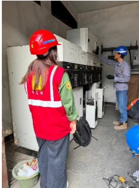
Gambar 2. 6 Inspeksi Pekerjaan test Trip CBO
