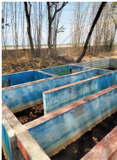
Gambar 2. 7 Instalasi Pengolahan Lindi
