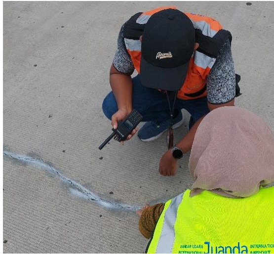
Gambar 2. 1 Inspeksi Runway Pasca Gempa (Sumber: Dokumentasi pribadi, 2024)
