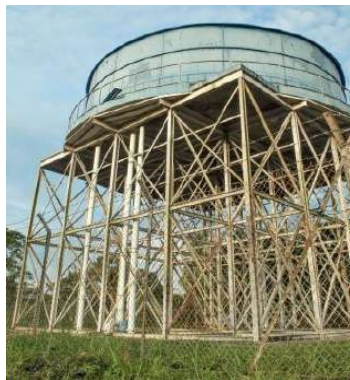
Gambar 2.28 Reservoar Tangki Baja
