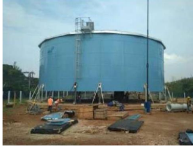
Gambar 2. 14 Reservoar Tangki Baja
