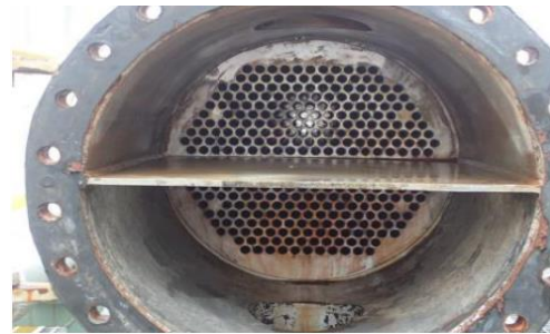
Gambar 18. Tube Ejector Condenser Setelah Cleaning
