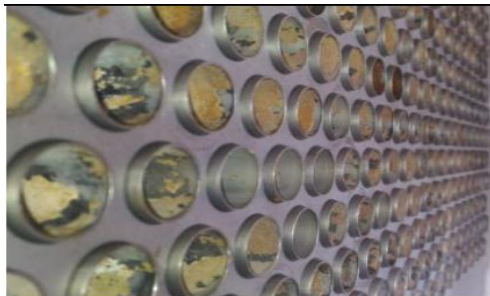
Gambar 3. Tube Module 1 Setelah Cleaning
