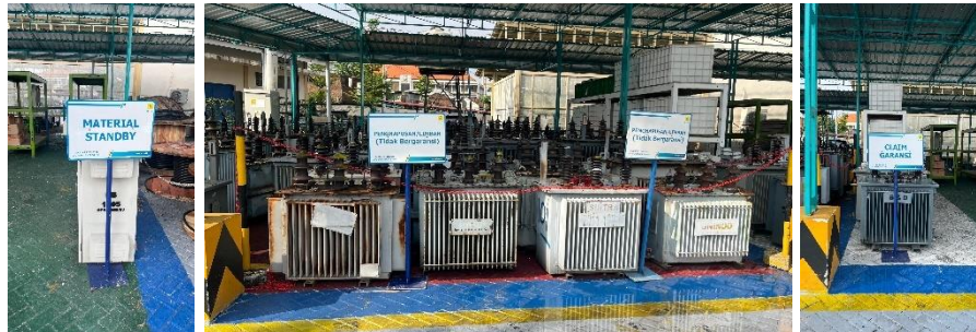
Gambar 1.1 Material Trafo dalam berbagai Status Pengelolaan
