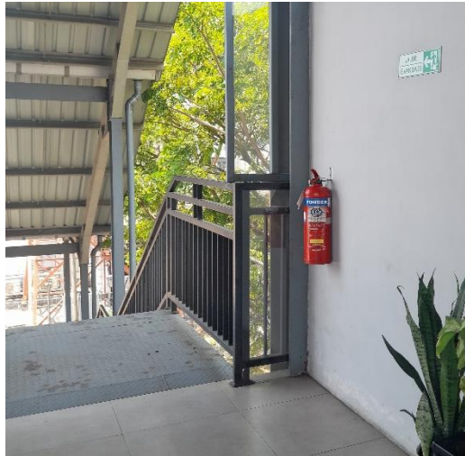
Gambar 2. 27 Ketersediaan APAR dalam fasilitas Stasiun KA Malang Baru
