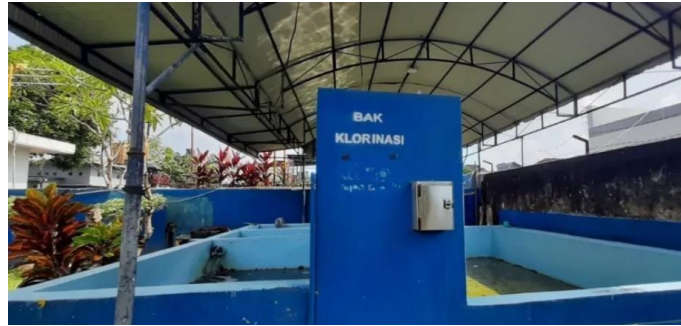
Gambar 21. Bak Klorinasi (Sumber : https://rsud.tulungagung.go.id )
