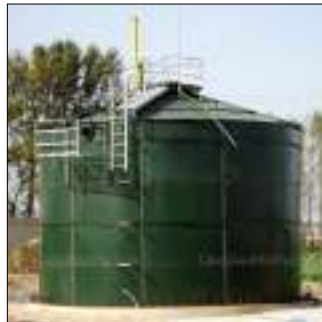
Gambar 2. 24 Reservoar Tanki Baja
