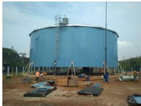
Gambar 22. Reservoar Tangki Baja
