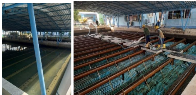
Gambar 2. 7 Unit Clarifier IPAM Ngagel 1 Surabaya (Sumber: Dokumentasi pribadi, 2023)
