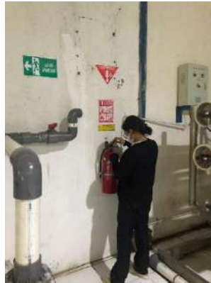
Gambar 2. 9 Self inspection APAR Sumber : Dokumentasi pribadi
