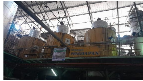
Gambar 4. Evaporator Pada Stasiun Penguapan
