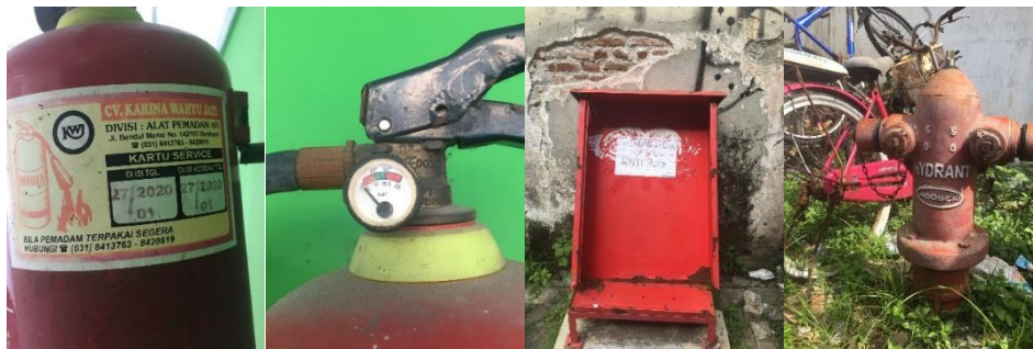
Gambar 1.3 Kondisi Fasilitas Pemadam Kebakaran di Rusunawa Gunungsari
