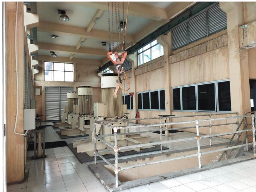
Gambar 2. 5 Pompa Menuju Aerasi
