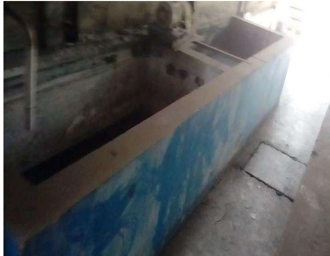
Gambar 5.3 Bak Penampung Air Blowdown 1 & 2
