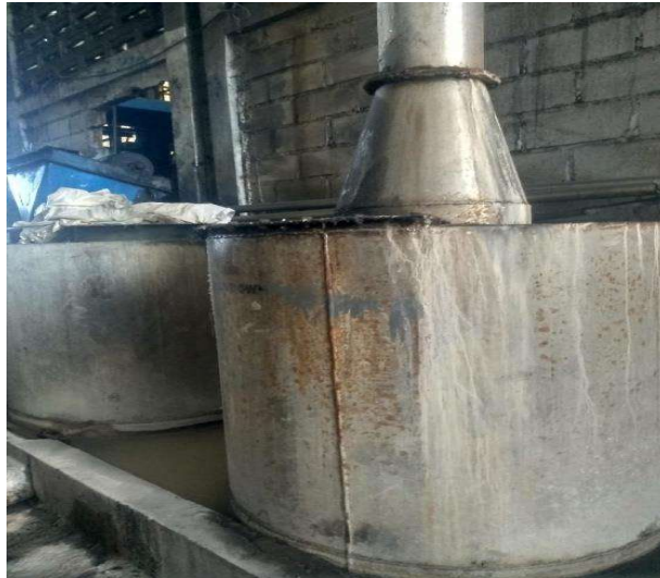
Gambar 5.2 Tabung Penampung Air Blowdown 1 & 2
