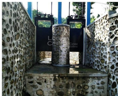
Gambar 2. 13 Penggunaan Pintu Air Intake
