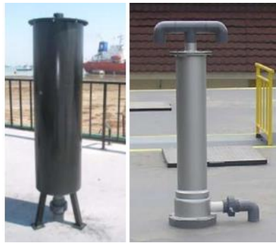
Gambar 2.3 Pipa Gas pada Biofilter Anaerob
