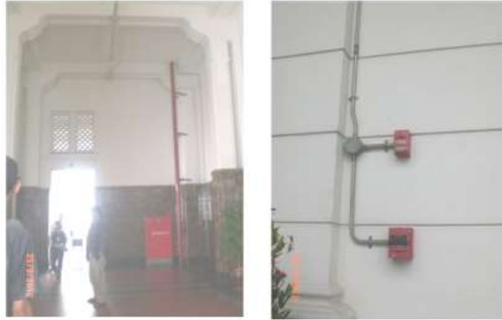
Perangkat system penanggulangan kebakaran
