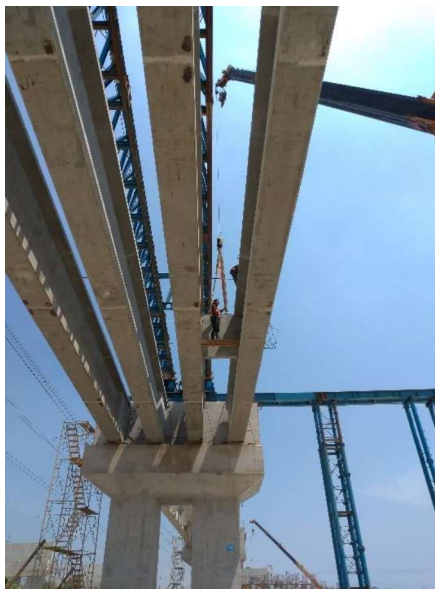
Gambar 1.1 Proses Pekerjaan PCI Girder pada Proyek JLLB (Sumber : Dokumentasi Pembangunan Proyek JLLB Kota Surabaya)
