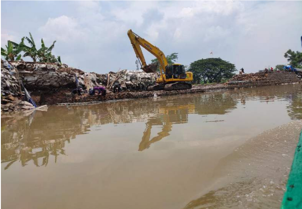
Gambar 1. 2 Tanggul Kali Kedunglarangan yang jebol akibat banjir
