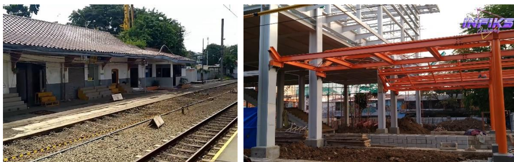
Gambar 1.1 Dari kiri ke kanan: Bangunan lama dibongkar dan diganti bangunan baru dalam tahap konstruksi
