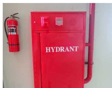
Gambar 5.45 Hidran dan Sprinkler.
