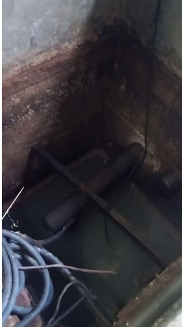
Rumah pompa di oil trap
