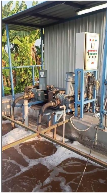
Blower untuk aerasi 1, 2
