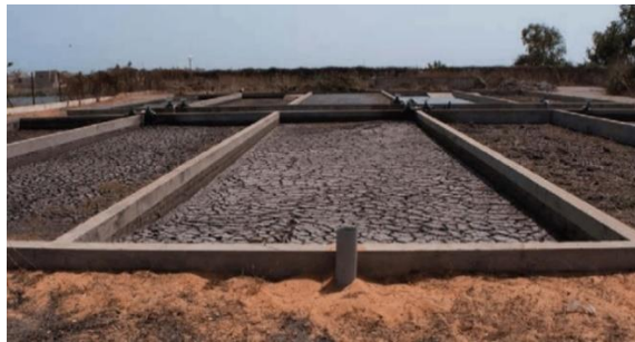
Gambar 2 . 14 Pengeringan pada Sludge Drying Bed
