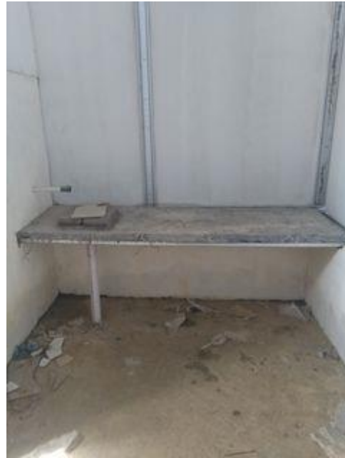
TIDAK TERDAPAT KITCHEN SINK
