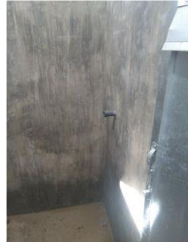
TIDAK TERPASANG KRAN AIR
