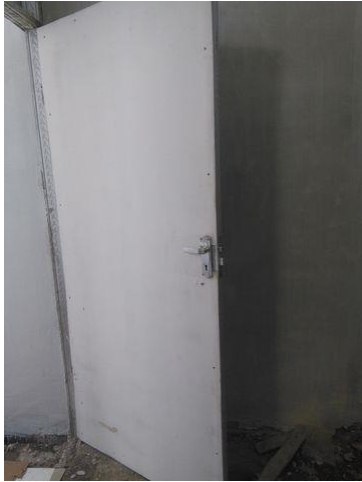
BELUM TERPASANG HANDLE PINTU
