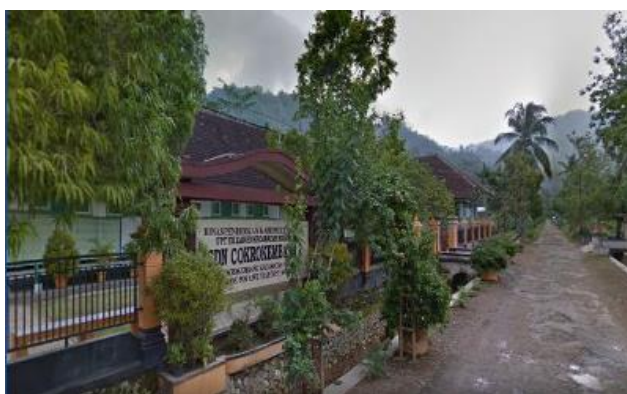
Gambar 4. 8 Kondisi Jalan Rusak di Desa Cokrokembang
