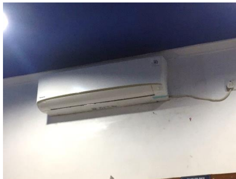
Gambar 2.53 AC sebagai penghawaan buatan ruangan
