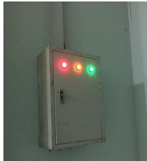
Gambar 2.68 Jaringan Listrik Di Perpustakaan Rungkut
