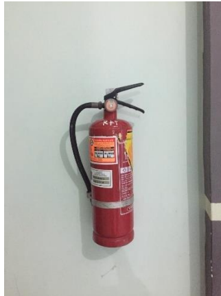
Gambar 2.69 Tabung pemadam kebakaran di setiap ruangan
