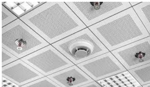
Gambar 5.33. Smoke Detector dan Sprinkle
