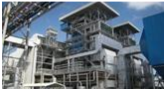
Gambar 1.4 Unit utilitas batubara PT. Petrokimia Gresik
