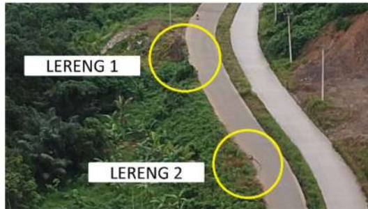
Gambar 1. Titik kelongsoran pada ruas jalan Ir. H. Nursyirwan Ismail, Ring Road II.
