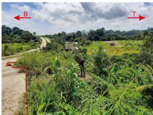
Gambar 2. Longsor pada lereng 1
