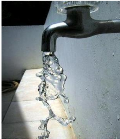
Gambar 2. 1 Fasilitas Air Bersih dalam Rumah
